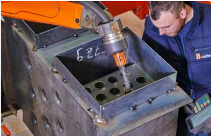
Durch den Einsatz der automatisierten Schweißtechnik können sich die Schweißer verstärkt auf die Prozessüberwachung konzentrieren
