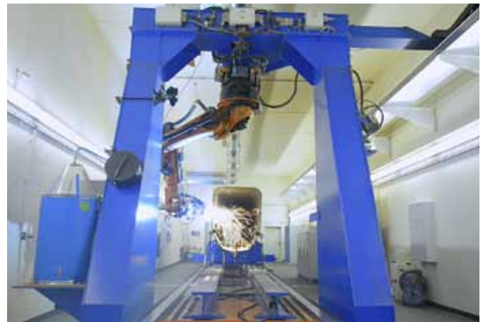
Bei der anschließenden Einbringung der Löcher wurden früher 15 Minuten pro Loch benötigt, der Laser schafft 30 Löcher in der gleichen Zeit.
